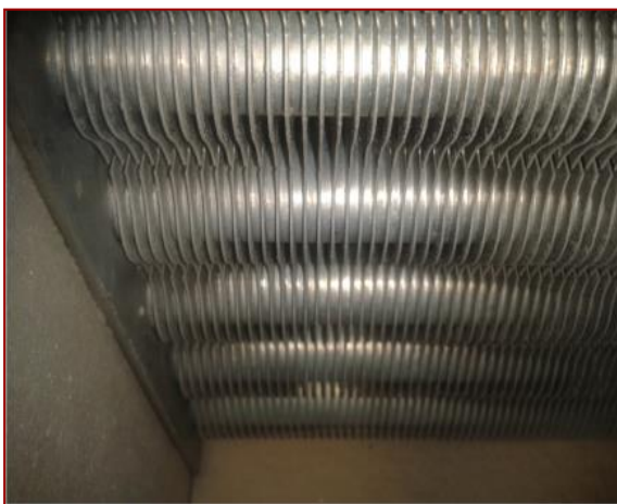
Состояние теплообменника после нескольких сезонов эксплуатации
